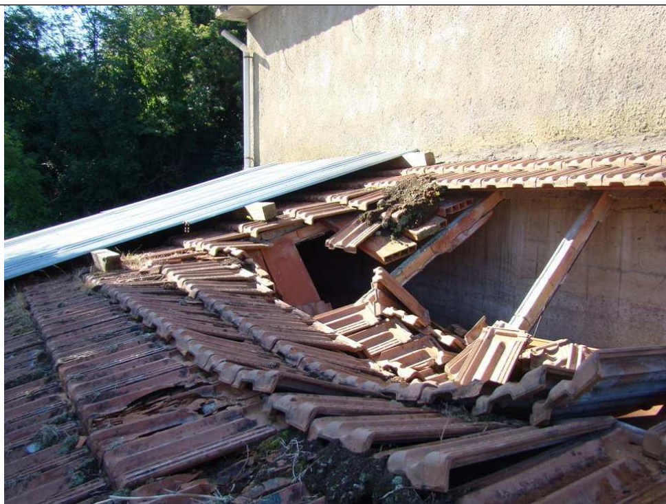
GALLERIA 2° LIVELLO – “LESIONI DELLA COPERTURA”
