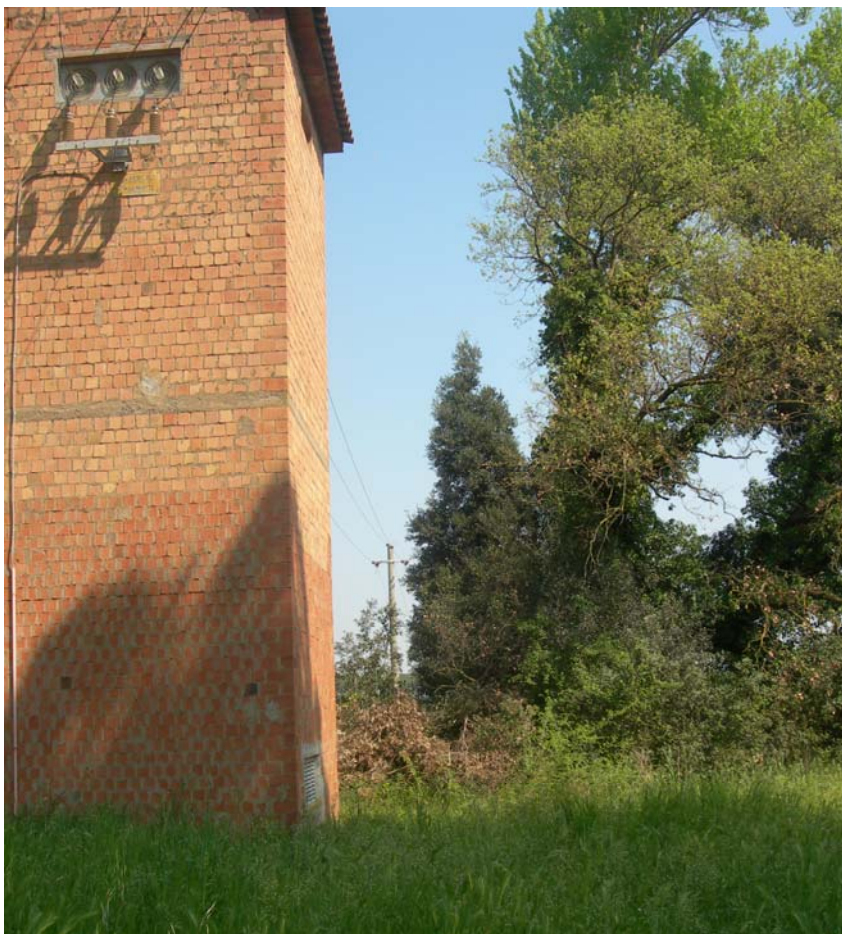
cabina elettrica nei pressi del Tombolo
