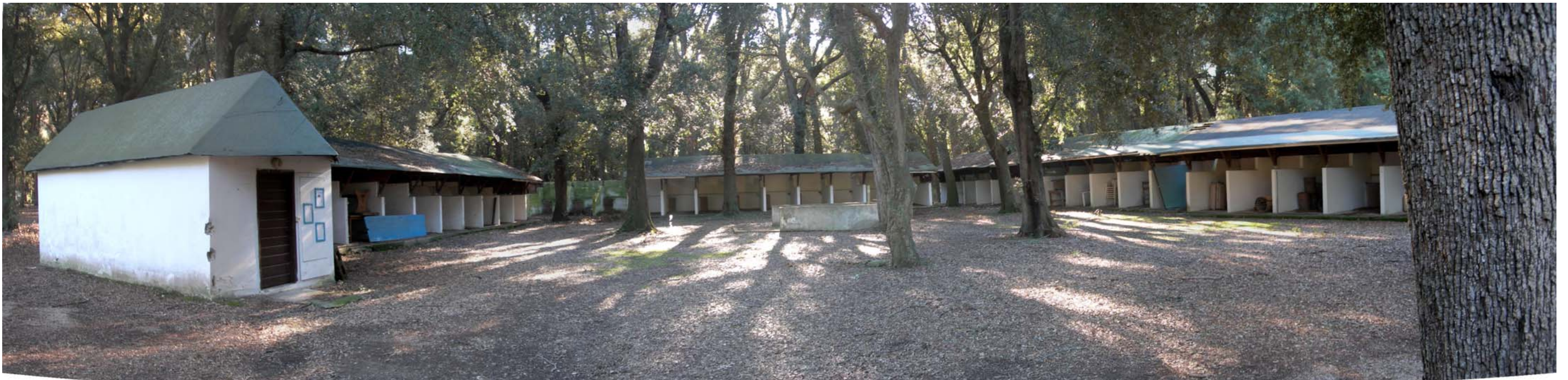
il degrado dei manufatti edilizi dell'ex club Méditerranée
