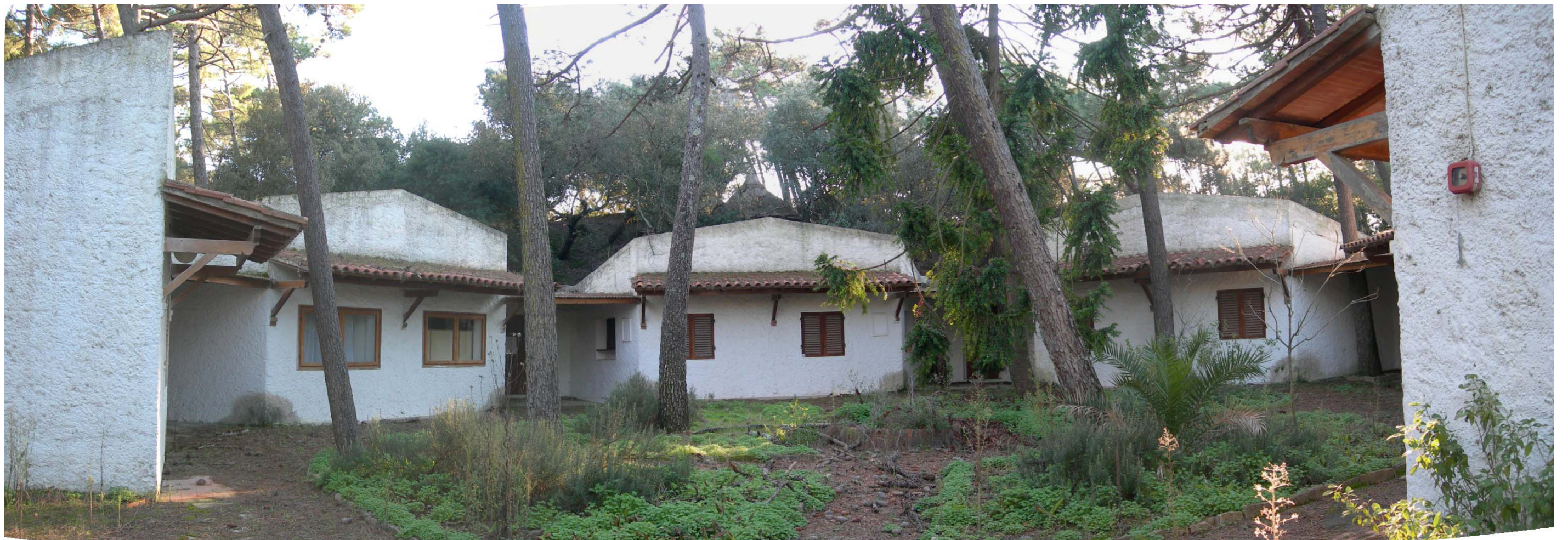
il degrado dei manufatti edilizi dell'ex club Méditerranée
