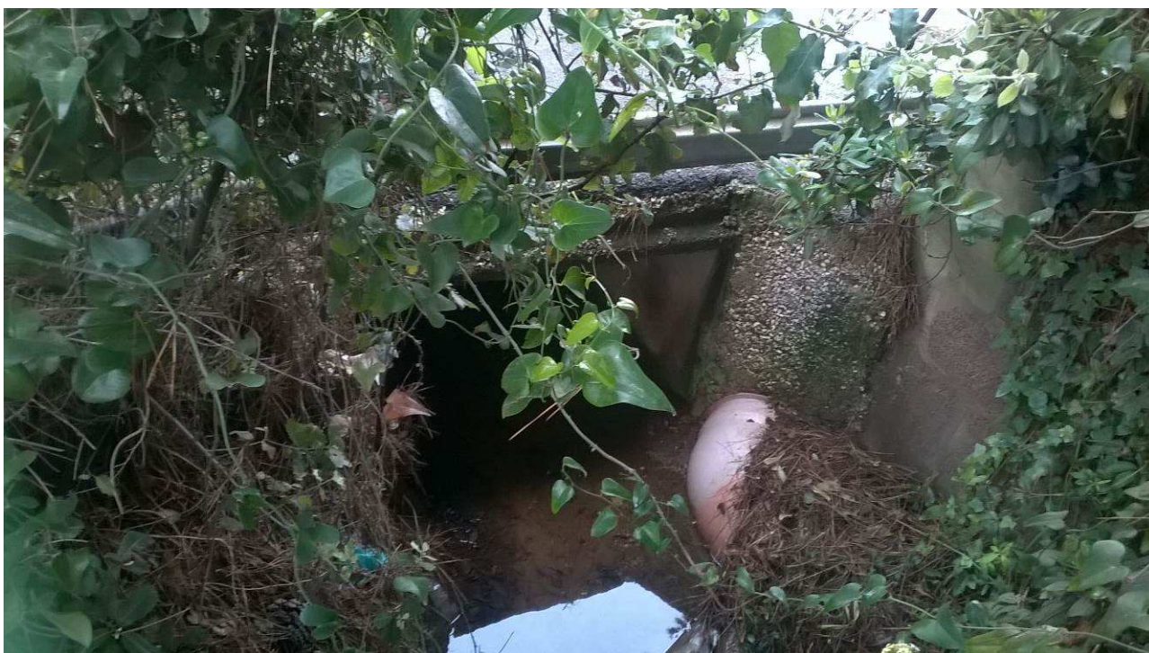
Figura 29 –Fosso Cipressetti attraversamento Viale Serristori nel tratto urbanizzato a valle della ferrovia
